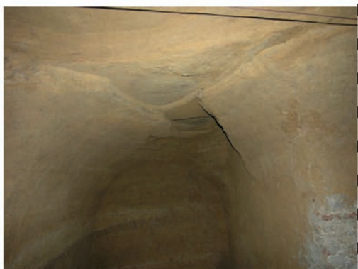
Fig. 39 - Distacchi di materiale lungo superfici di strato nella cavità n. 12
