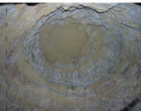
Fig. 38 - Distacco di materiale da una volta scavata in arenarie glauconitiche nella cavità n. 5
